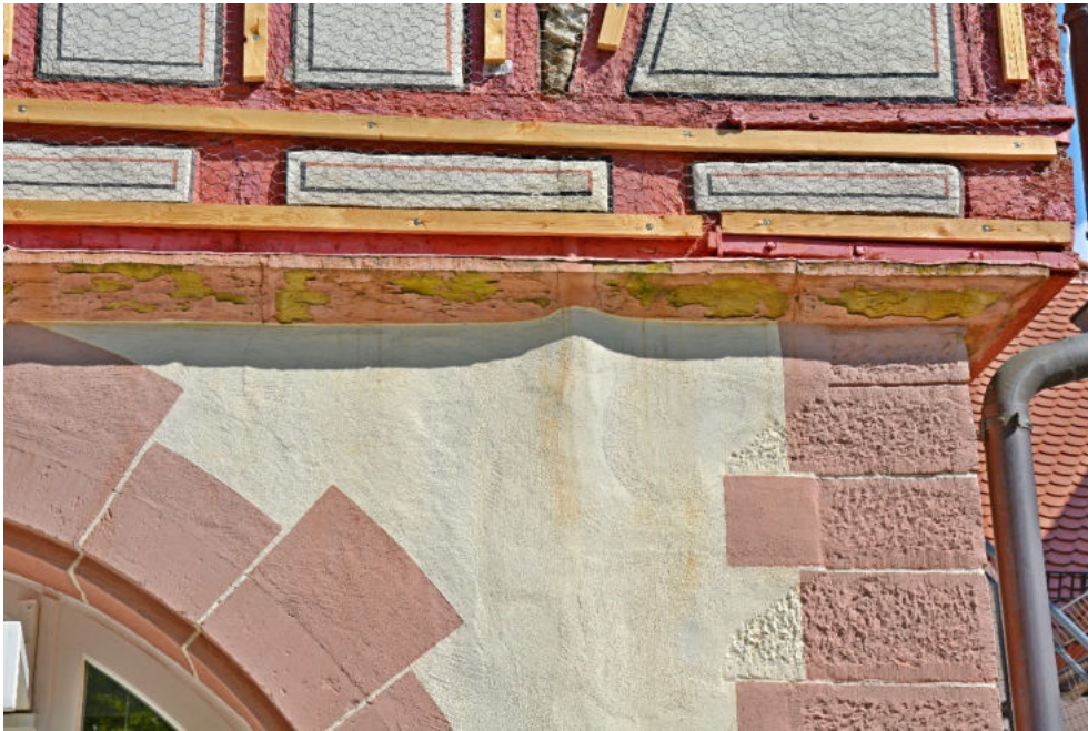
Abb.03 , Ansicht West, Gesims mit aufschuppender Farbe, farbig idealisierter Steinverlauf
