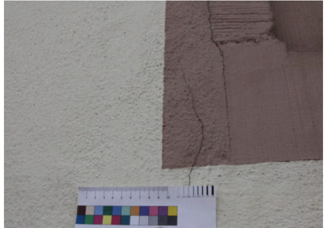
Abb. 25: Nordseite - vertikaler Riss entlang des Fenstergewändes
