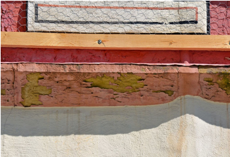
Abb.11 , Ansicht West, abblätternde Farbe, aufschuppender Sandstein
