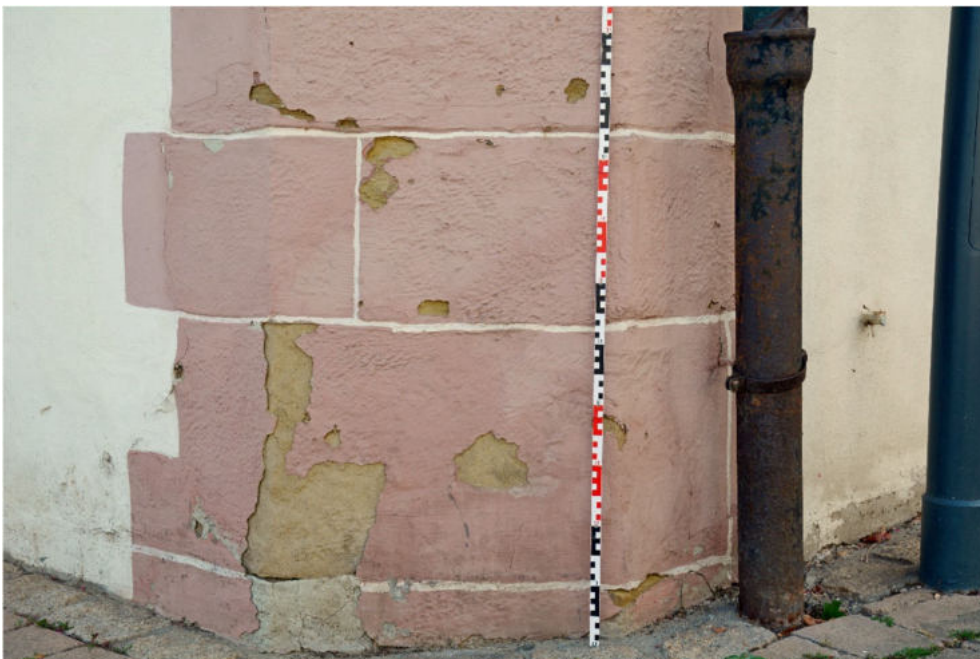
Abb.06 , Ecke Nordost, Sockelzone mit abblätternder Farbe
