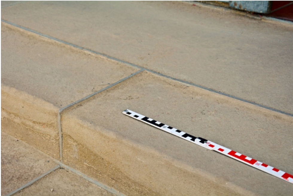
Abb.05 , Ost-Seite, abstehende Fugen auf zurückgewitterten Sandsteinstufen
