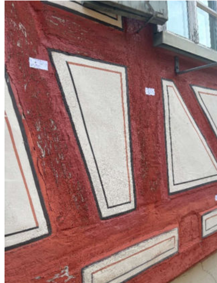
Abbildung 1 erkennbare Schäden der Beschichtung und Bohrmarken
