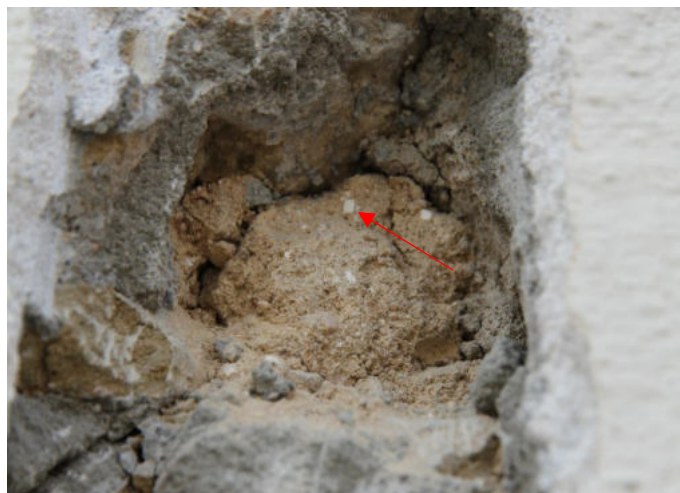
Abb. 16: Nordseite - Sondierungsöffnung Mauermörtel mit Kalkspatzen (Pfeil).
