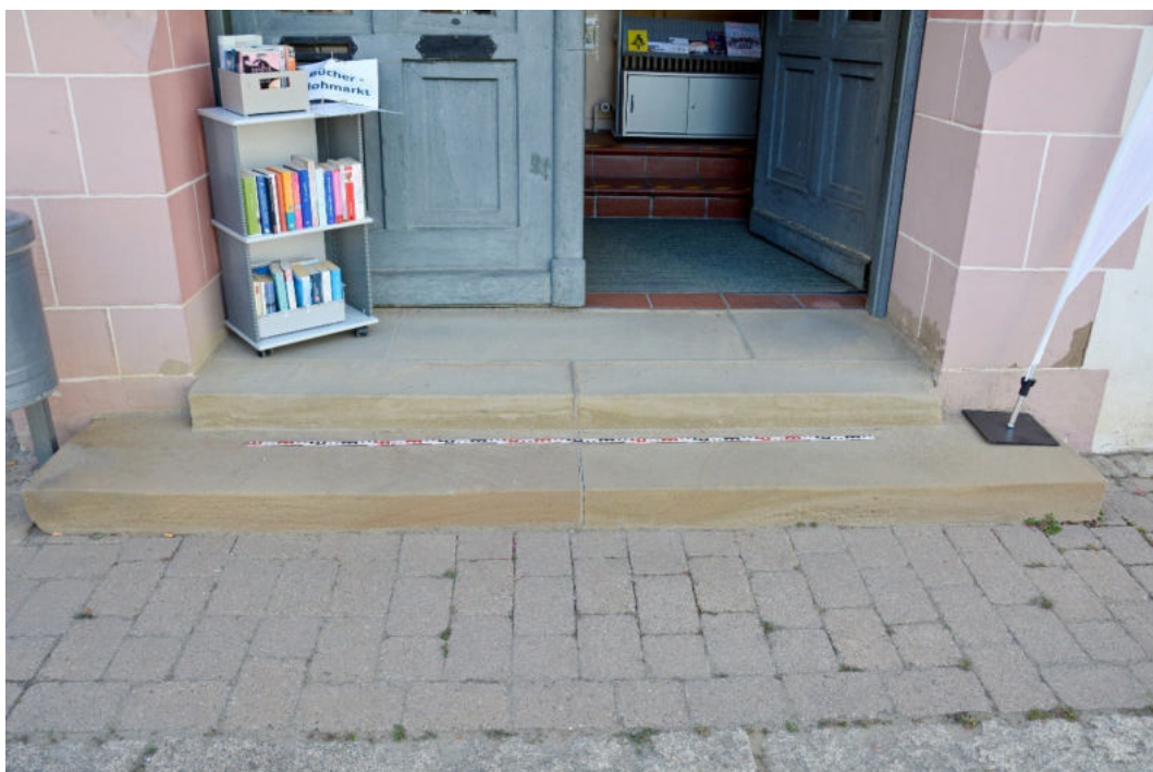
Ost-Seite, Sandsteinstufen mit Zementfugen
