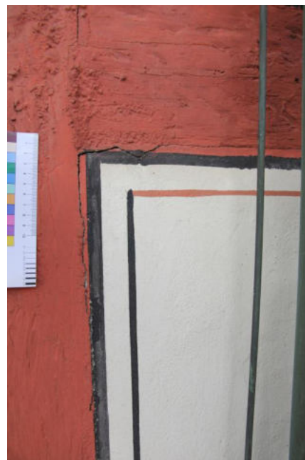
Abb. 27: Abriss zwischen Gefach und Holz
