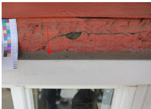
Abb. 28: dauerelastische Fuge am Fenster (Pfeil)
