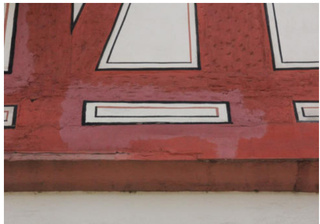
Abb. 23: Nordseite - deutlich sichtbare Ausbesserungen
